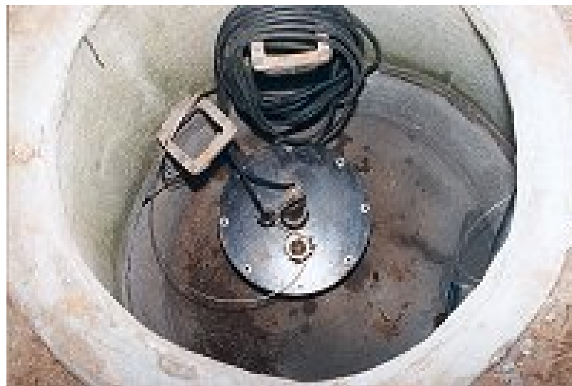
Шахта скважины (Всасывающая скважина)
