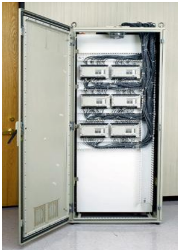
Пространство, занимаемое традиционным оборудованием в/в
